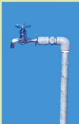
露出配管状況
